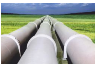
Energia Hidráulica e Pneumática
